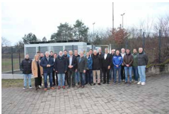
Zur Präsentation der neuen Heizzentrale am Sportzentrum Erbach waren sehr viele Verantwortliche und beteiligte Firmen anwesend. Das Bild entstand vor der Verbund-Wärmepumpe, die aus drei einzelnen Anlagen besteht © Jürgen Kruthoff
