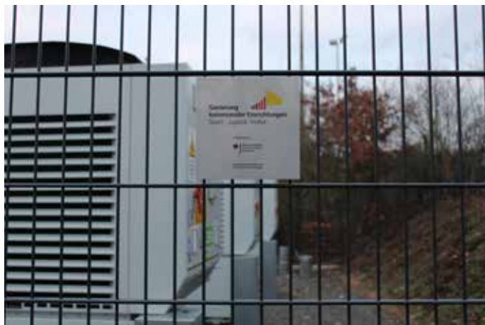
Für die neue Anlage erhielt die HPS GmbH insgesamt Fördermittel in Höhe von 850.000 Euro © Jürgen Kruthoff
